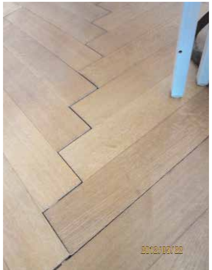
Bild 5: Parkettaufwölbung über einem unzulässig aufgebogenen, bis zur Innenwand durchlaufenden Stahlträger infolge von Lastumlagerungen aus Balkonträgern
