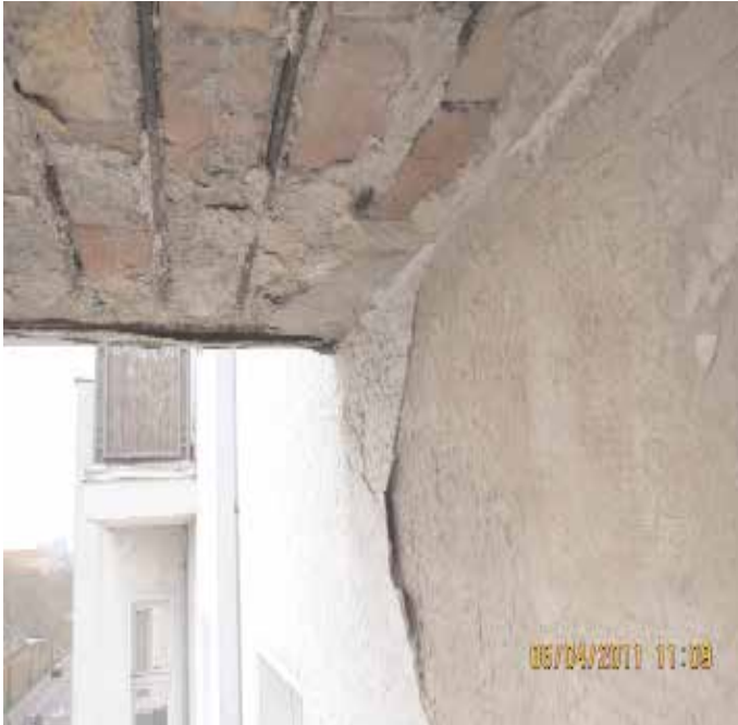
Bild 2: Korrodierte Eiseneinlagen einer Steineisendecke führten zu großflächiger Putzabspaltung
