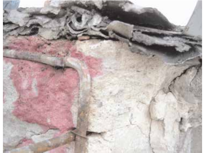
Bild 3: Die Karbonatisierungsfront des Betons befindet sich hinter den Einlagen einer Eisenbetondecke (lilafarbener Bereich), die Eisen haben ihren Korrosionsschutz verloren, sind dort korrodiert und haben zu Rissen im Beton und Putzabplatzungen geführt
