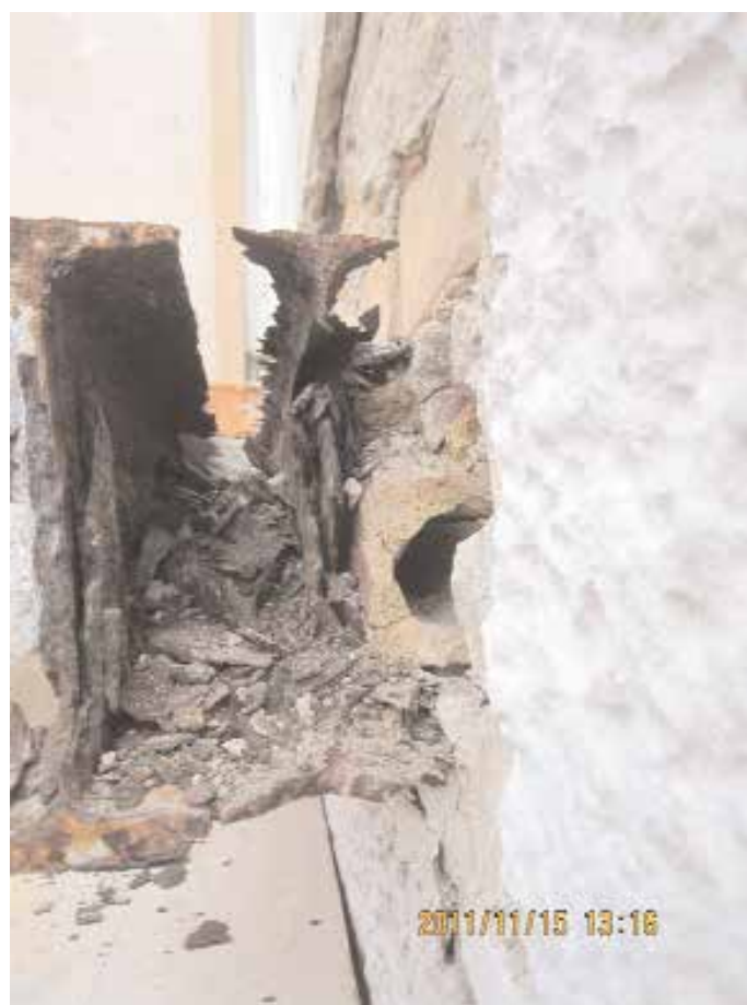
Bild 1: Reste stählerner Balkonträger nach erfolgter Freilegung
