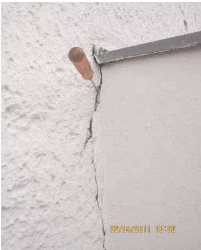
Bild 4: Das Brüstungsmauerwerk hat sich infolge unzulässiger Durchbiegung der Stahlträger mit einem kräftigen Abriss vom Fassadenmauerwerk getrennt
